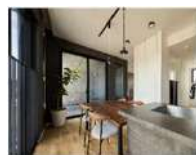
P01～ 天井変更工事 勾配天井工事 天井高UP 下がり天井
